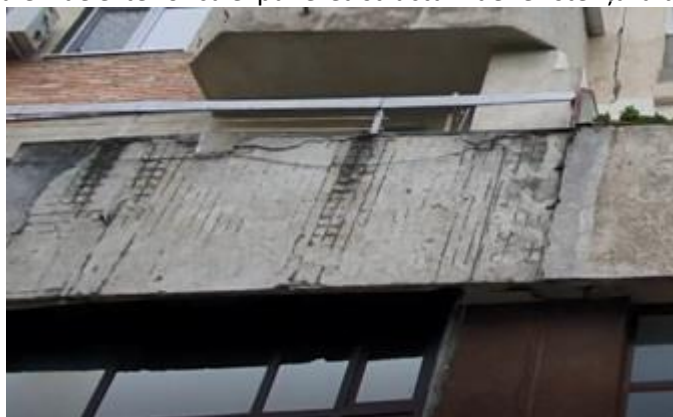
Figura 3: degradare tipică parapetei la balcoane
