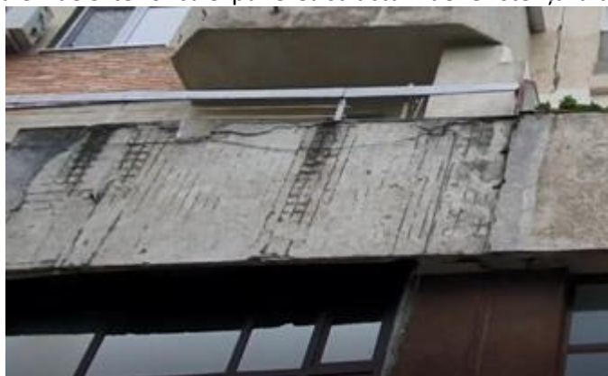
Figura 3: degradare tipică parapetei la balcoane
