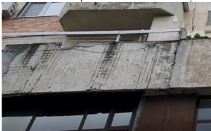
Figura 3: degradare tipică parapetei la balcoane
