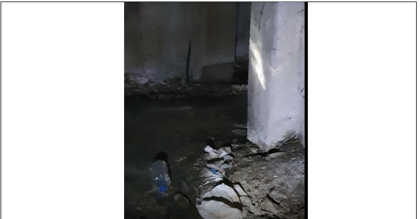
Figura 23: Subsol G2- inundat si plin de nămol
